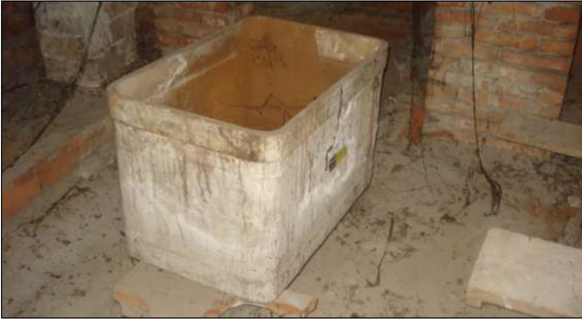
IMM08_foto sottotetto: vasca in eternit (dismessa). Da rimuovere a carico di ditta abilitata.
